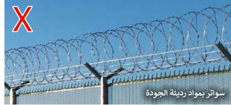
سواتر بمواد رديئة الجودة
